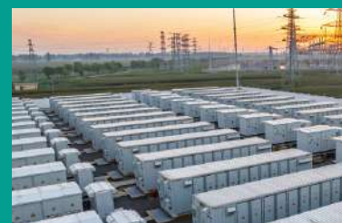
ii) Unidades de armazenamento
